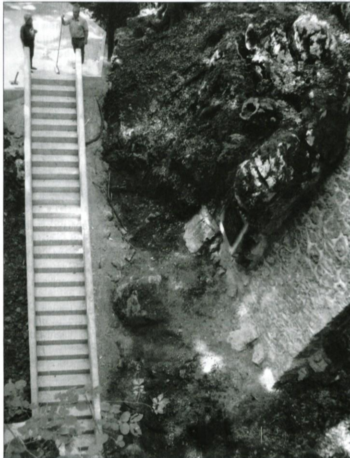
Popravljen stopnice in podporna stena ob vhodu v Županovo jamo. - foto D. Samec
