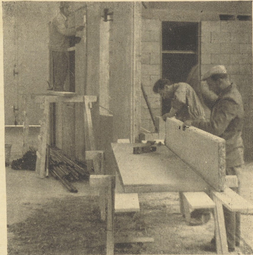
Na Zagrebškem velesejmu bomo pokazali, kakšna je naša industrializirana gradnja stanovanj po PBM sistemu
