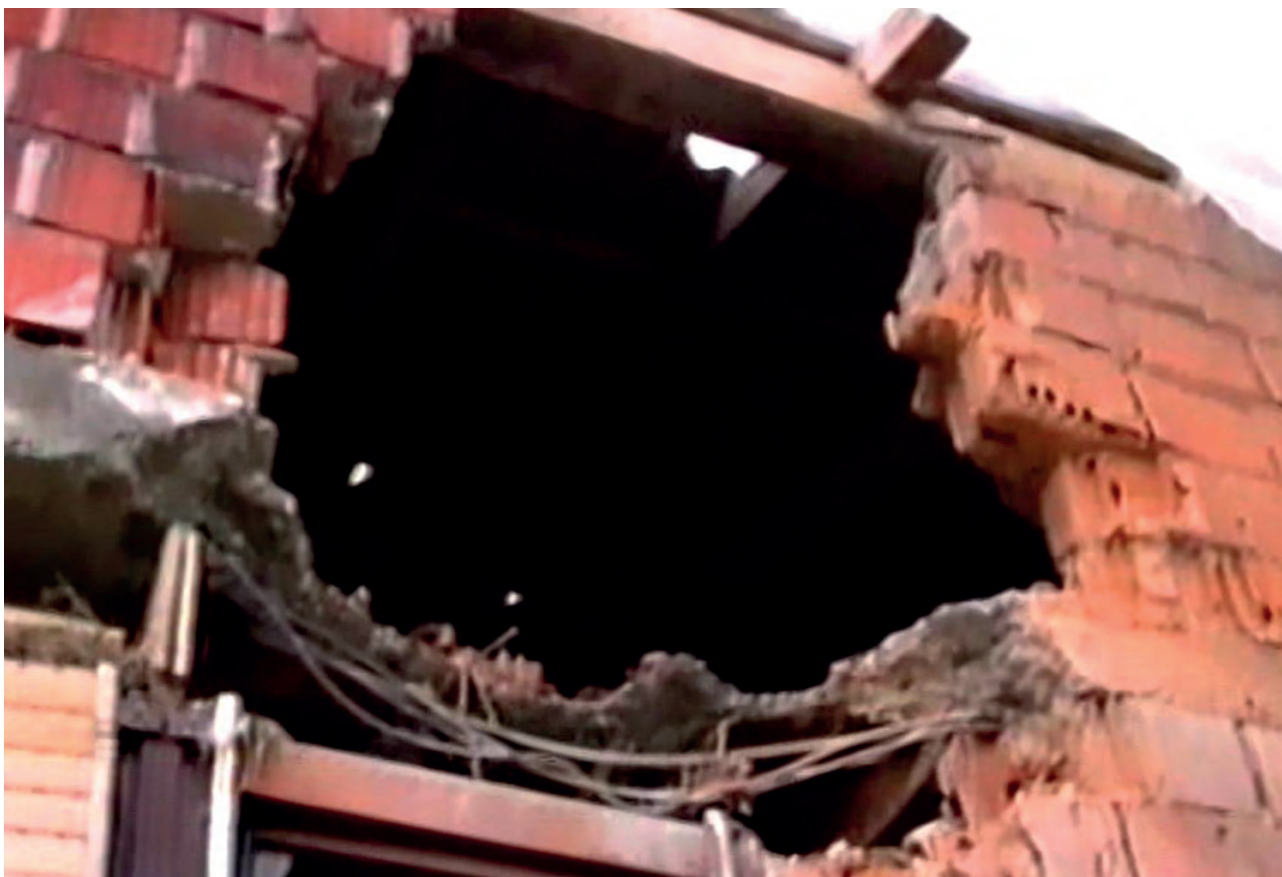
Arhiv OZVVS Ljutomer – Poškodbe na objektih v Gibini
