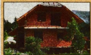
PODLJUBELJ - prodamo visokopritlično hišo v tretji gradbeni fazi. Tloris 9 x 8 m. Hiša ima 200 m2 uporabnih površin, stoji pa na 450 m2 veliki parceli na robu naselja. Cena je 13,5 mil. SIT. SVET NEPREMIČNINE
