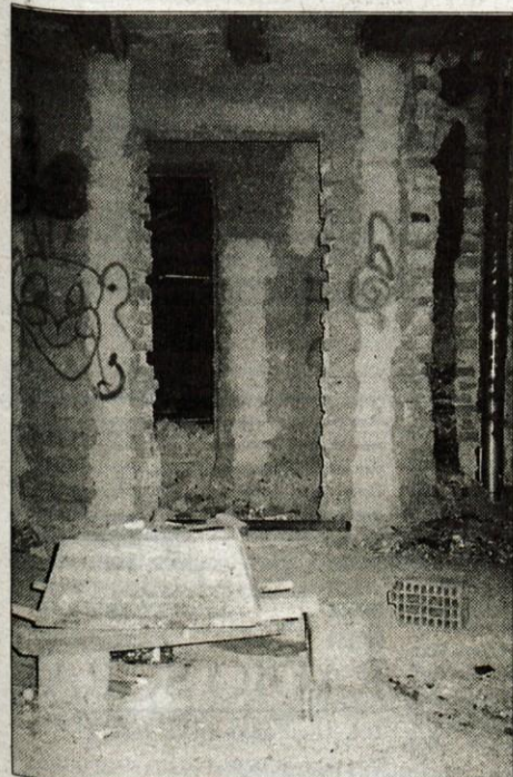
Izpujene cevi in prebit dostop v prostor pod odrom dvorane.
