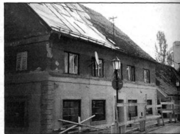
Iz strehe odpada polomljena kritina, verjetno pa je močno deževje v preteklih tednih tudi močno razmočilo že tako dotrajano ostrešje. Kdo po poskrbel, da se ne bo zgodil velenjski kolizej?
