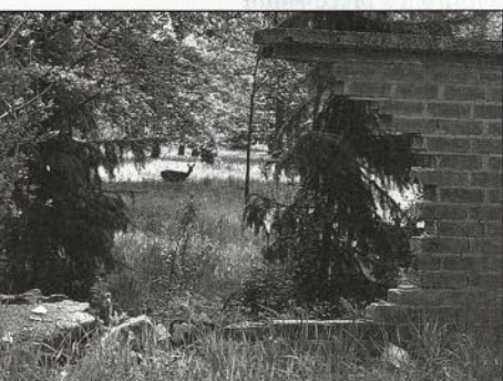
Porušeni zid ob parku dvorca Turnišče. Foto: Aleš Šprah
