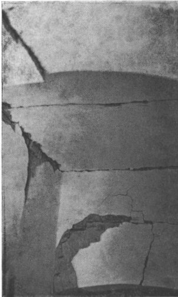
Navidez močni oboki in stropi zibiške šole so popustili in se zrušili
