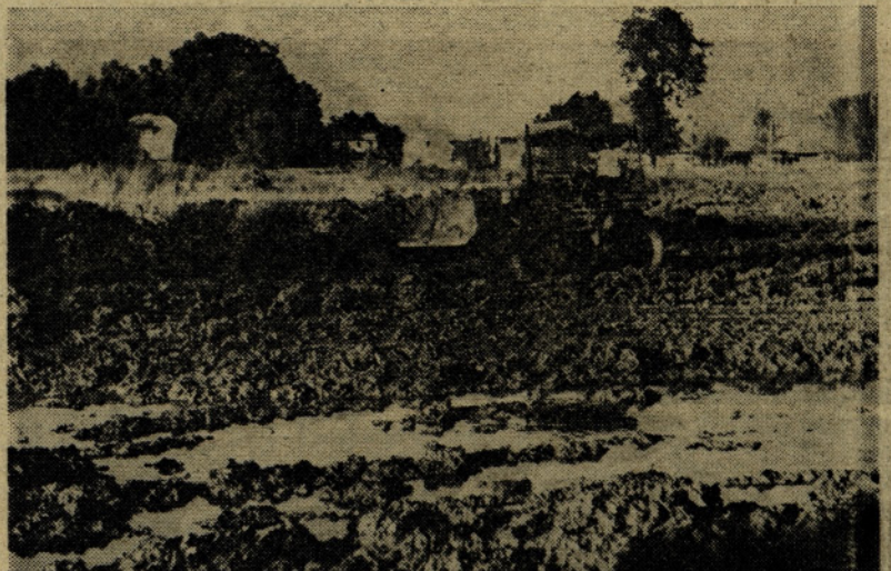
Jeseni leta 1974 so začeli buldožerji pripravljati zemljišče za gradnjo rekreacijskega centra. Opravljeno je bilo veliko delo.
