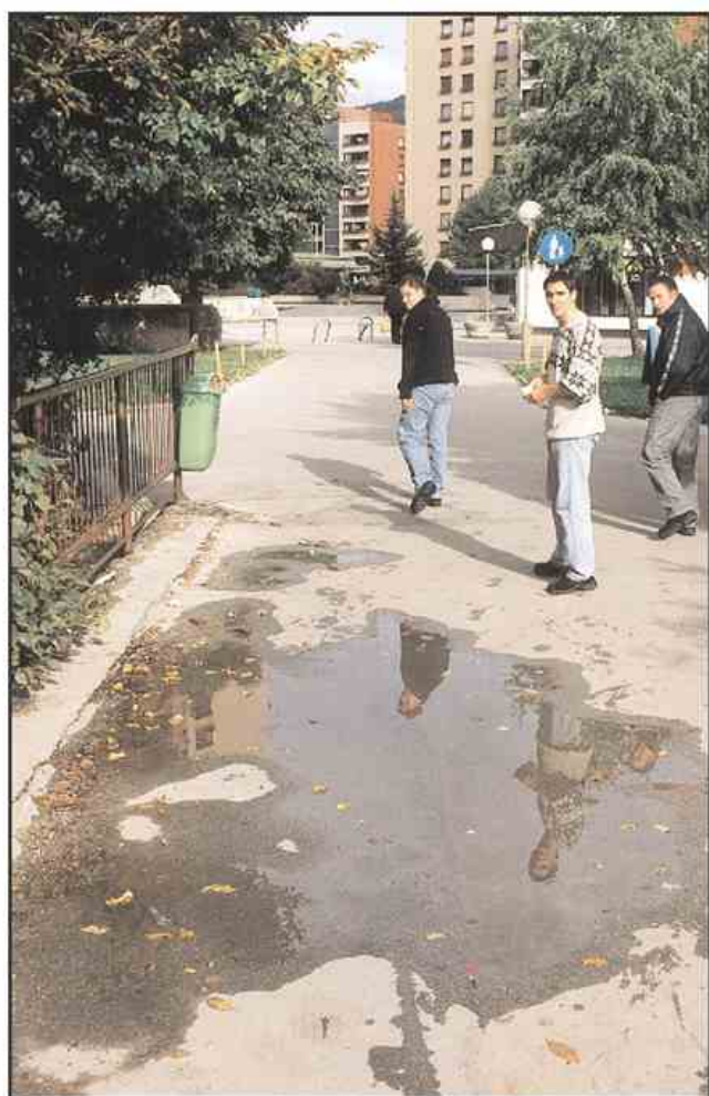
Že prvi most, ki vodi na Kardeljev trg, je dokaz slabe izvedbe. Še dolgo po dežju se zaradi posejanja na njem lahko opazujemo v naravnih ogledalih - velikih lužah.
