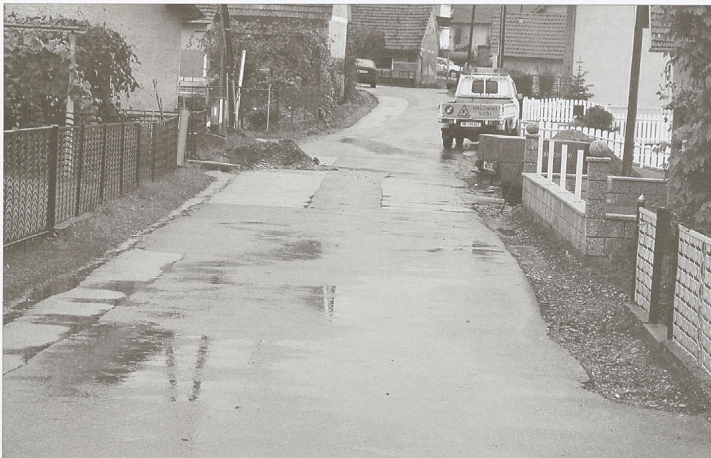
V Hajdošah so pred kratkim zaključili z rekonstrukcijo dotrajanega vodovodnega omrežja s ponikovanjem.
