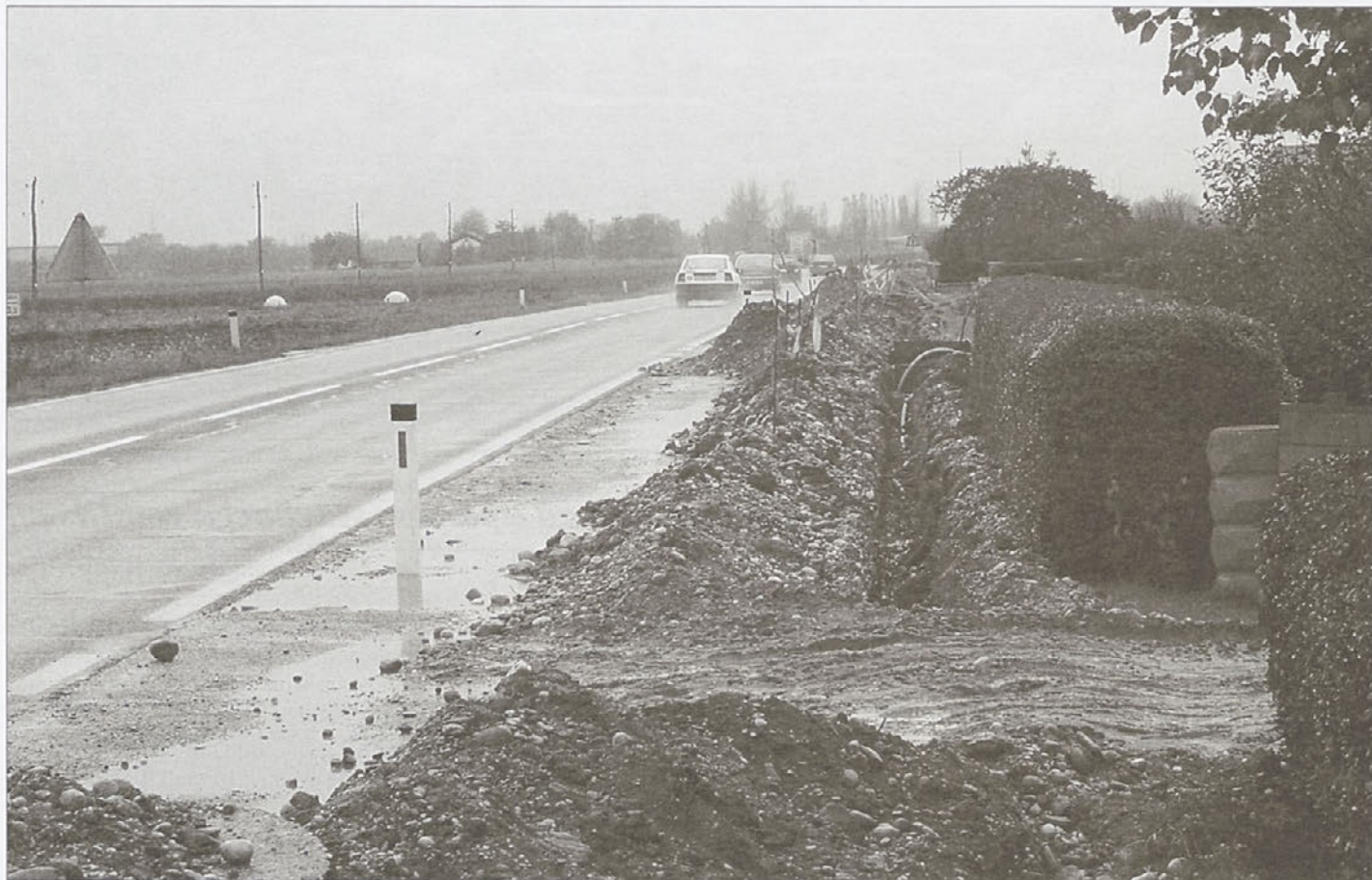
V Hajdošah in Slovenji vasi poteka izgradnja javne razsvetljave ob glavni cesti Ptuj - Maribor.
