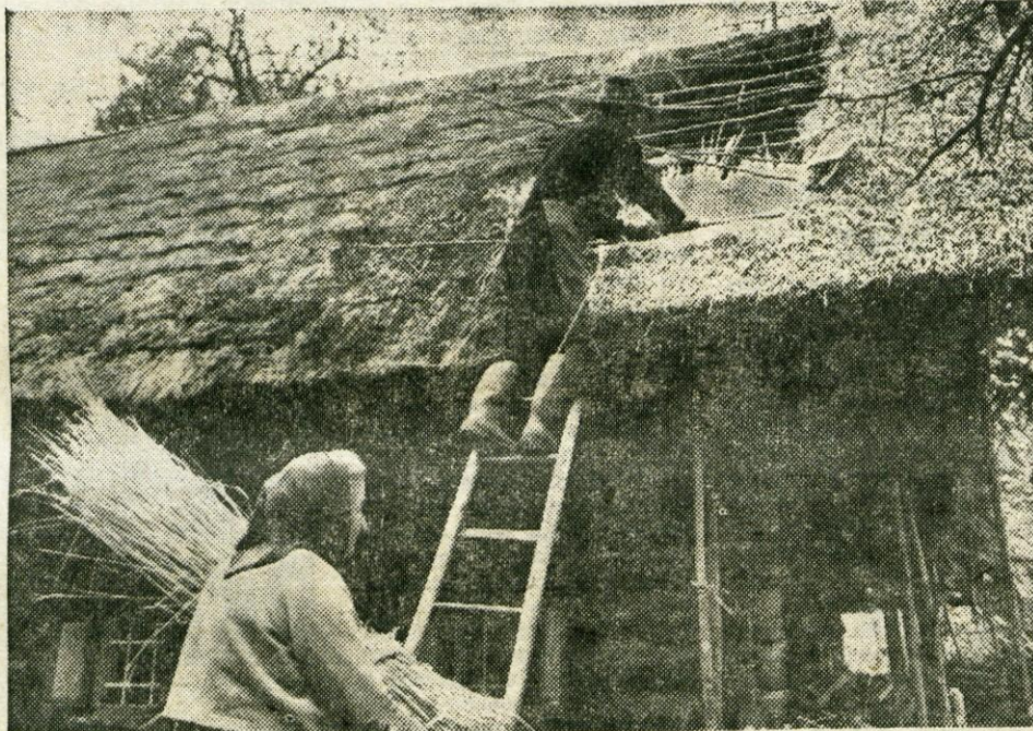
Na Flegarjevi hiši v Poženiku bodo prekrili slamnato streho — Foto Franc Perdan
