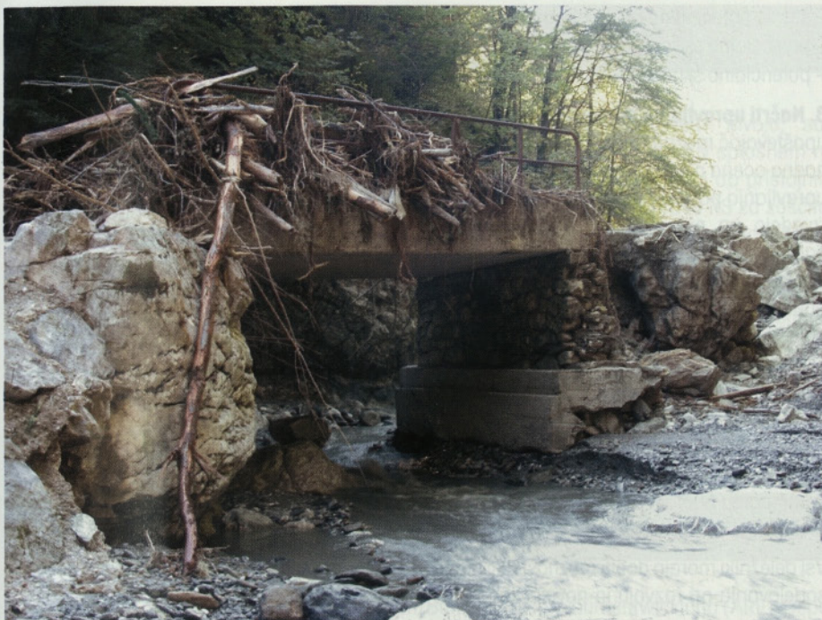
Slika 6 • Porušeni most na cesti ob hudourniku Davča (foto: avtor, 22. 9. 2007)
