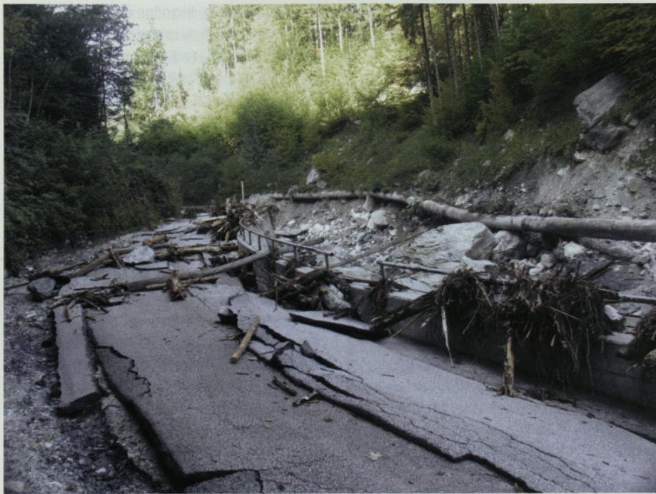
Slika 4 • Močno poškodovana cesta ob hudourniku Davča, kjer je spodkopalo temelje obrežnega podpornega zidu, poglobilo strugo hudournika in poškodovalo dovodni cevovod za MHE (foto: avtor, 22. 9. 2007)
