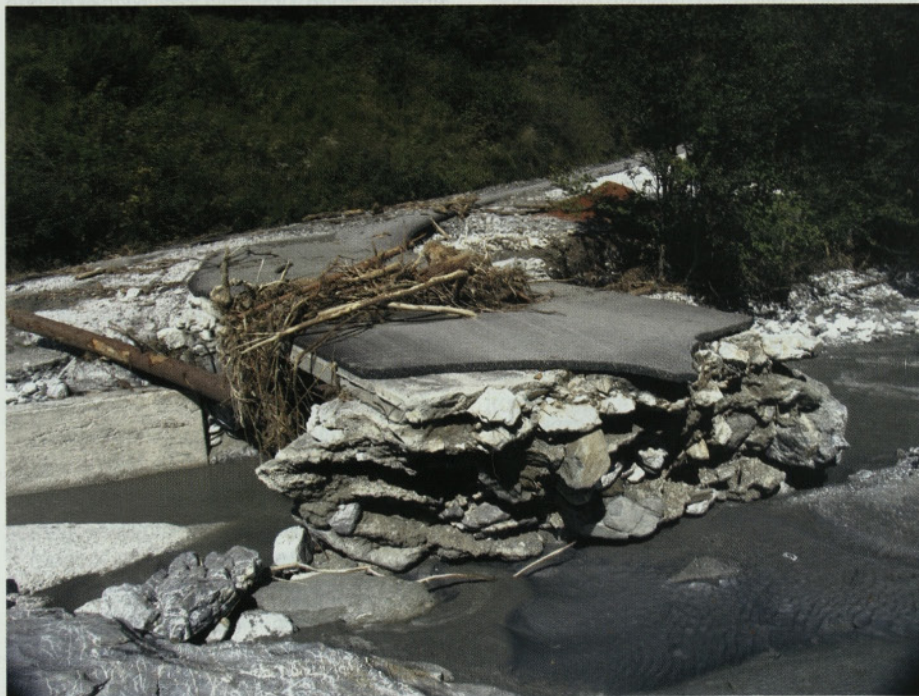
Slika 5 • Porušeni most na cesti ob hudourniku Davča (foto: avtor, 22. 9. 2007)
