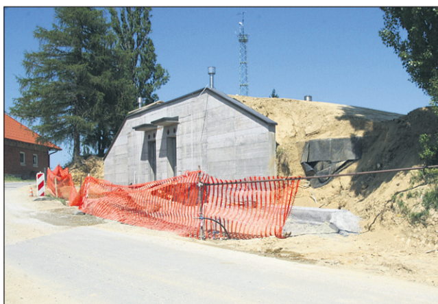
Trenutno se pospešeno izvajajo dela na vodohranu Jeruzalem, kjer je objekt v fazi zasipavanja.
