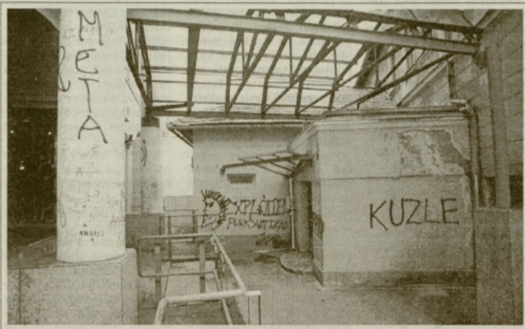
Prehod ob Ljubljanski 3a kaže vse prej kot podobo urejenega objekta.
