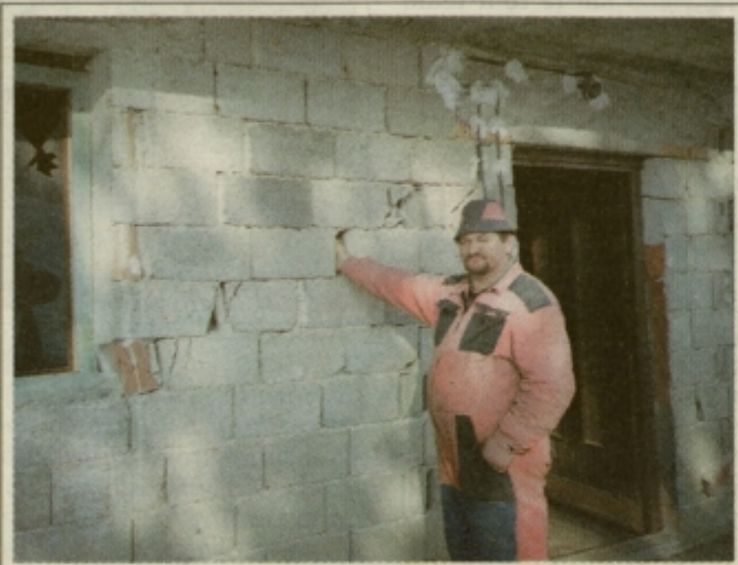
Nada in Anton sta zgradila prostorno stanovanjsko hišo, ki jo zadnjih pet let razjedajo razpoke. Tako velike, da lahko vanje položiš roko.
