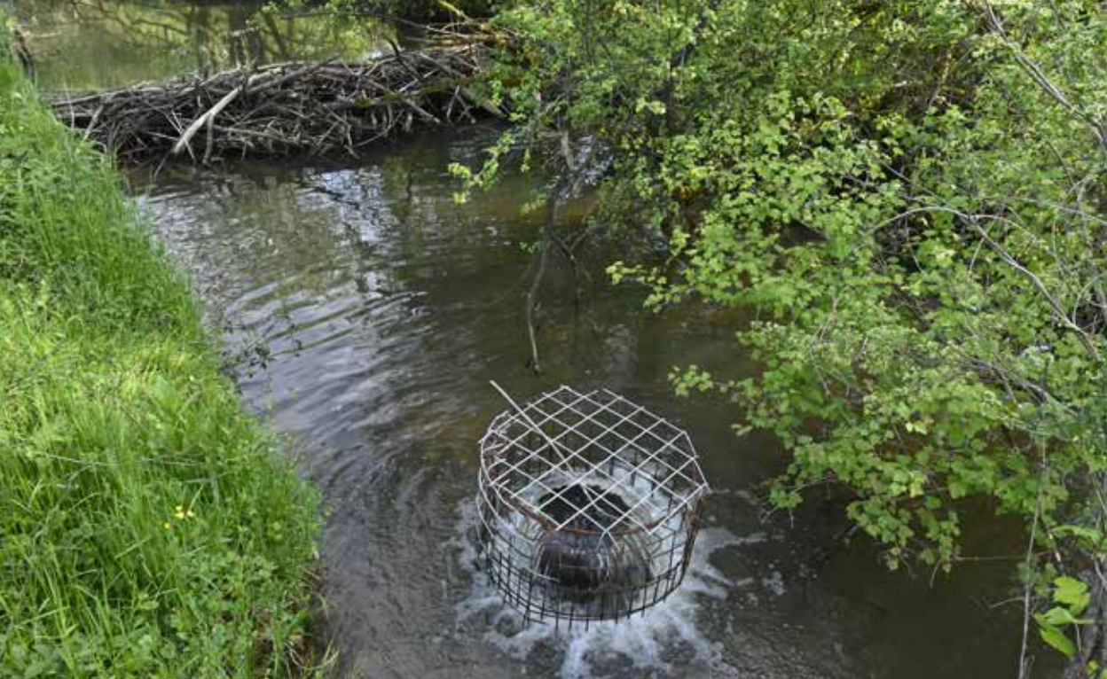
Cevni prepust pod jezom na Žerjavinskem potoku preprečuje poplavljanje. Foto: Andrej Hudoklin
