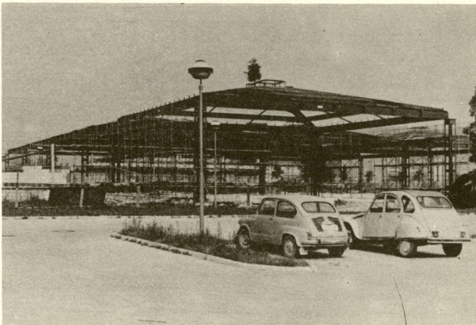
Naš predelovalni center na Črnučah pri Ljubljani je že „zrasel“ do vrha. Dokaz je smrečica gradbincev na najvišji točki zgradbe.
