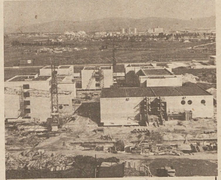
Za Bežigradom v Ljubljani, v neposredni bližini Fakultete za sociologijo, politične vede in novinarstvo, grade delavci ljubljanskega Gradisa naj sodobnejši ekonomski visokošolski center v državi. Že na jesen, to je z novim šolskim letom, bodo nove predavalnice sprejele prve študente... (Foto: A. Ul.)
