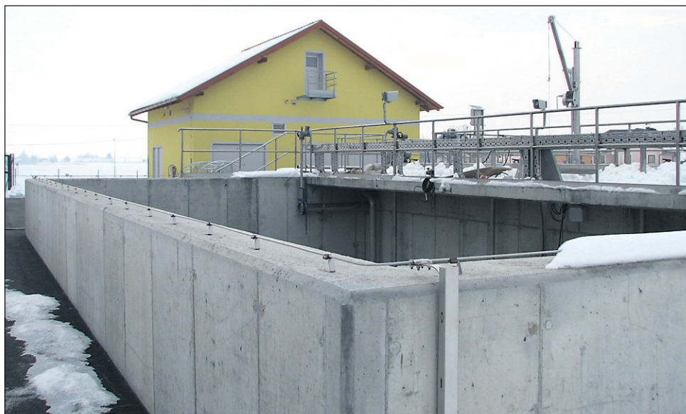
Čistilna naprava v Zamušanih je v teh dneh že v poskusnem zagonu, nanjo bodo vezana gospodinjstva iz Gorišnice, Moškanjcev in Zamušanov.
