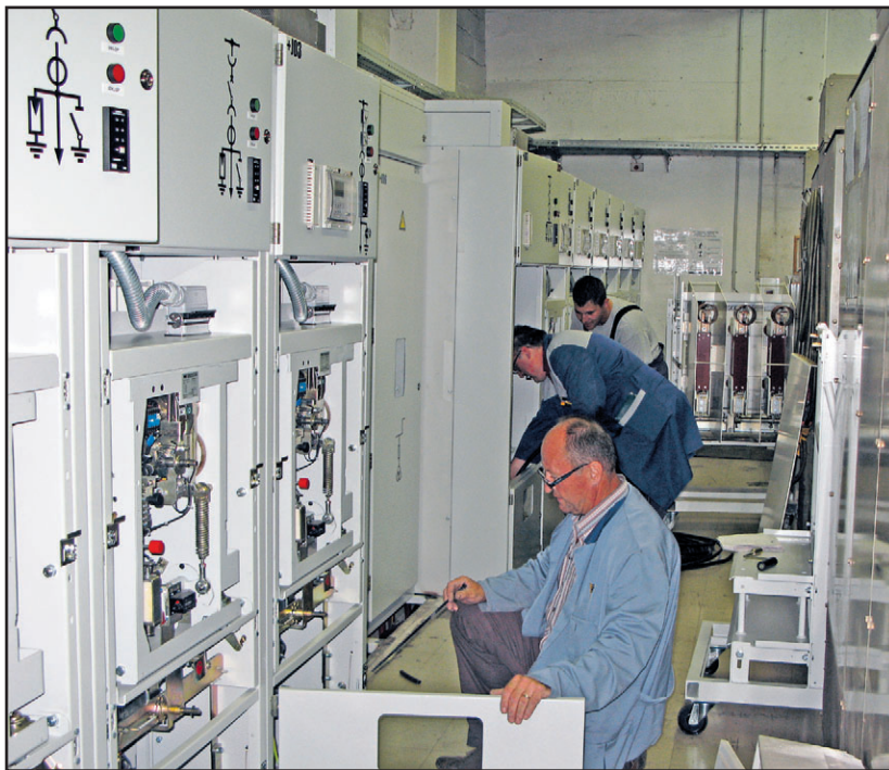
Posodobili so med drugim razdelilno transformatorsko postajo.
