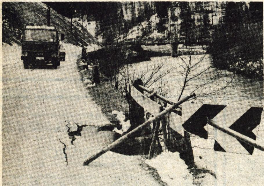
Žiri — Cesta med Fužinami in Selom ima 4 tone nosilnosti. To pomeni, da vsak šofer avtobusa ali tovornjak pelje po njej na lastno odgovornost. Razen tega je na več mestih spodjedena in se že pojavljajo udori, ki so zelo nevarni, ker je cesta ozka in ovinkasta. Zlasti pa so nevarni, če so slabo zavarovani. Posnetek je nastal v »Peklu« na Selu. — Foto: F. Perdan
