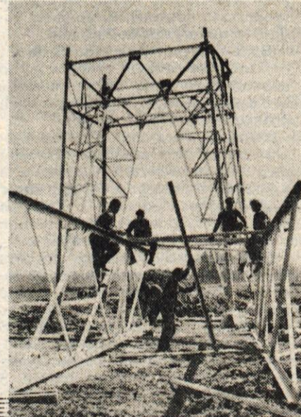
Do nove razdelilne transformatorske postaje Okroglo bo od podobne v Beričevem postavljen 400-kilovoltni daljnovod, ki ga že gradijo, nared pa bo do konca leta. Nov daljnovod bodo nato zgradili tudi od Kranja do Jesenic, saj se bo z novo elektroeklarano poraba elektrike na Gorenjskem močno povečala. Foto: F. Perdan
