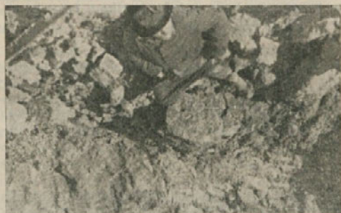
Smrtna nesreča pri nezavarovanih zemeljskih delih
