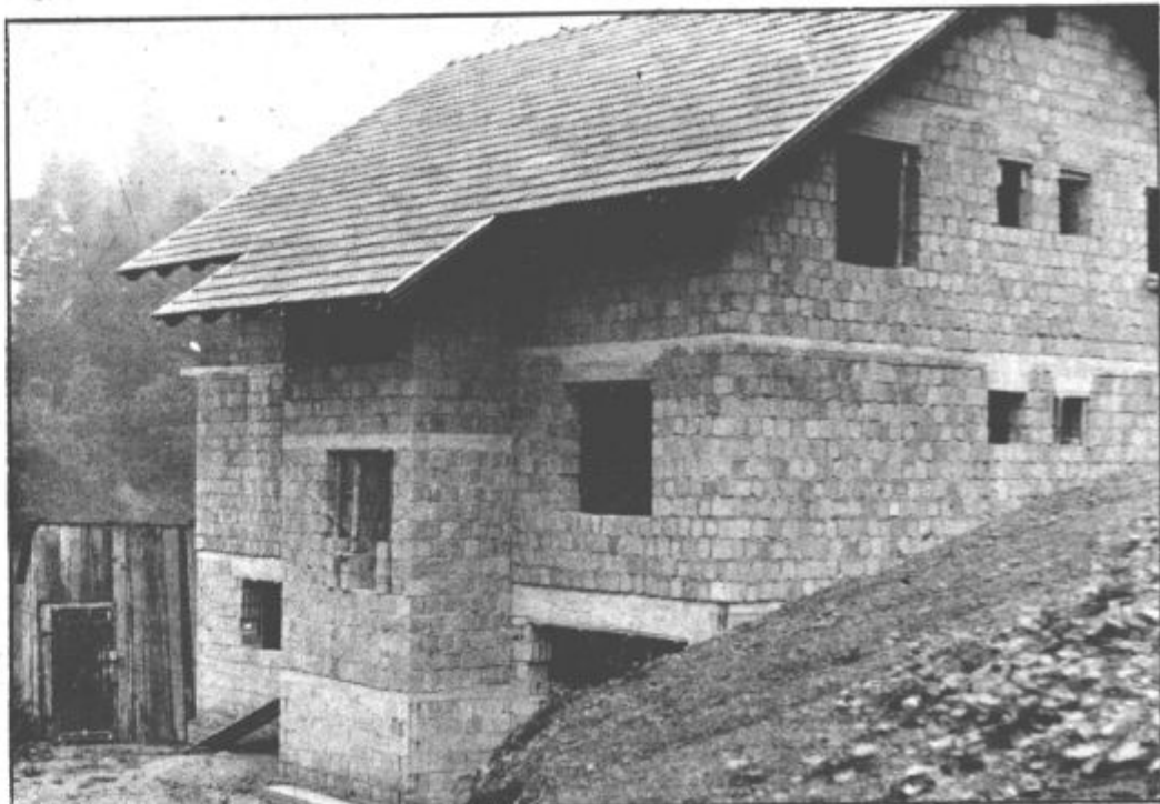
Črna gradnja v Florjanu
