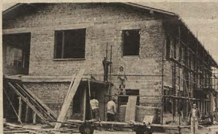
V kratkem bo končano preurejanje stare žage in pisarniških prostorov TOZD INLES v Sodražici. Dela opravlja Gradisce iz Cerknice. (Foto: J. Primc)
