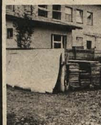
Pripravljala dela za gradnjo prizidka metliškemu zdravstvenemu domu so v polnem teku. Na sliki: novo gradbišče na nekdanjem „mestnem parku“, za katerim zalujejo predvsem otroci
