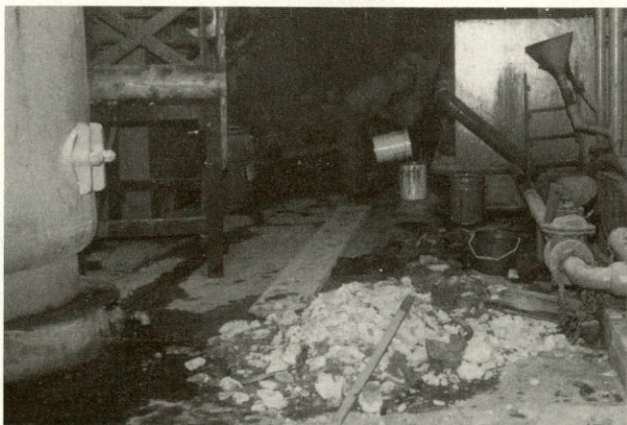
V kleti stare barvarne izvajajo remont že tretjo leto. Tokrat naj bi se dela v celoti dokončala. Generalna obnova kleti je bila potrebna zaradi uničevalnega učinka vlage na železobetonsko armaturo.
