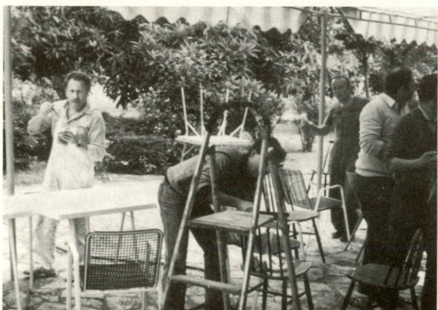
Namesto počitniških slik iz Umaga vam iz tega kraja prikazujemo še dve delovni. Obe sta posneti zadnji dan, ko so bili delavci Induplati ali zunanji sodelavci pri koncu s planiranimi opravili in popravili na počitniškem domu. Zgornji posnetek kaže, da znajo moški ne samo pleskati, temveč tudi pomivati, tako da so se stoli po končanem delu spet svetili.
