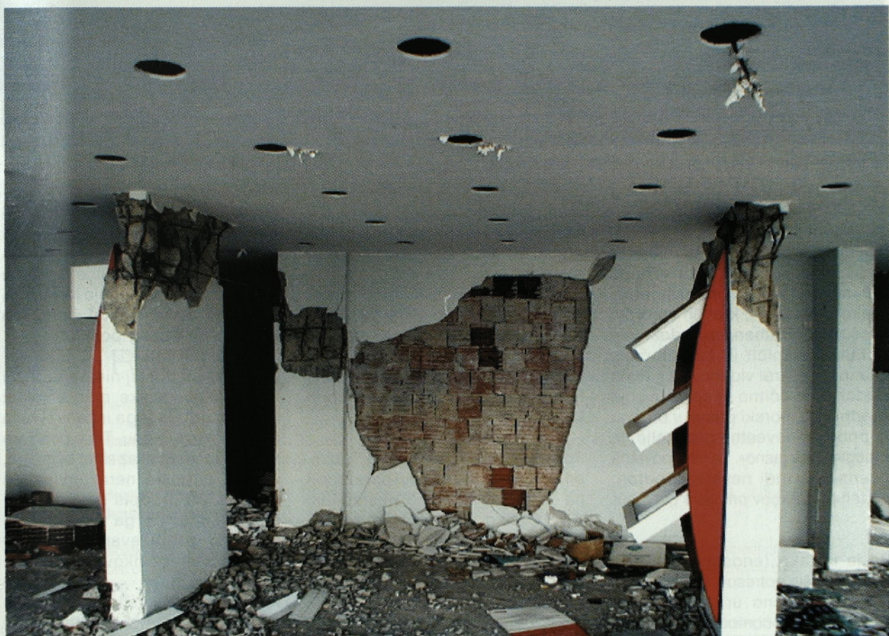
Slika 15. Porušitev stebrov v šibki smeri. Polnilo je pomagalo obvarovati zgradbo pred popolno poružitvijo
