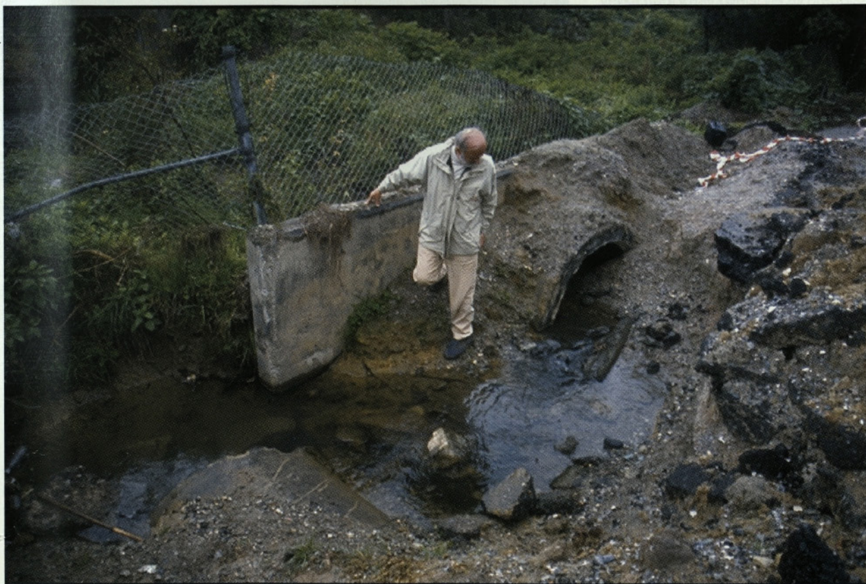
Slika 2. Prelomljena kanalizacijska cev priča o 3.5 m velikem desnem zmiku preloma
