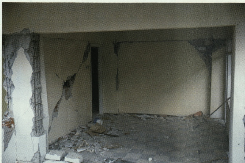
Slika 7. Značilne poškodbe polnil (križna strižna porušitev, drobljenje vogalov, izpad v prečni smeri)
