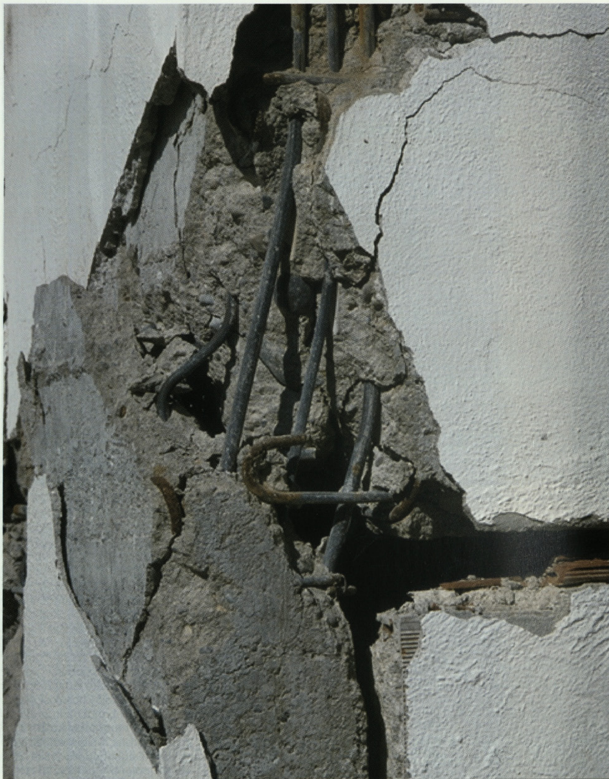
Slika 14. Neustrezna izvedba vozlišča
