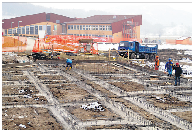
Delavci gradbenega podjetja Nivo gradnje in ekologija iz Celja ob novi šoli v Majšperku v teh dneh gradijo novo nogometno in tenis igrišče z razsvetljavo.
