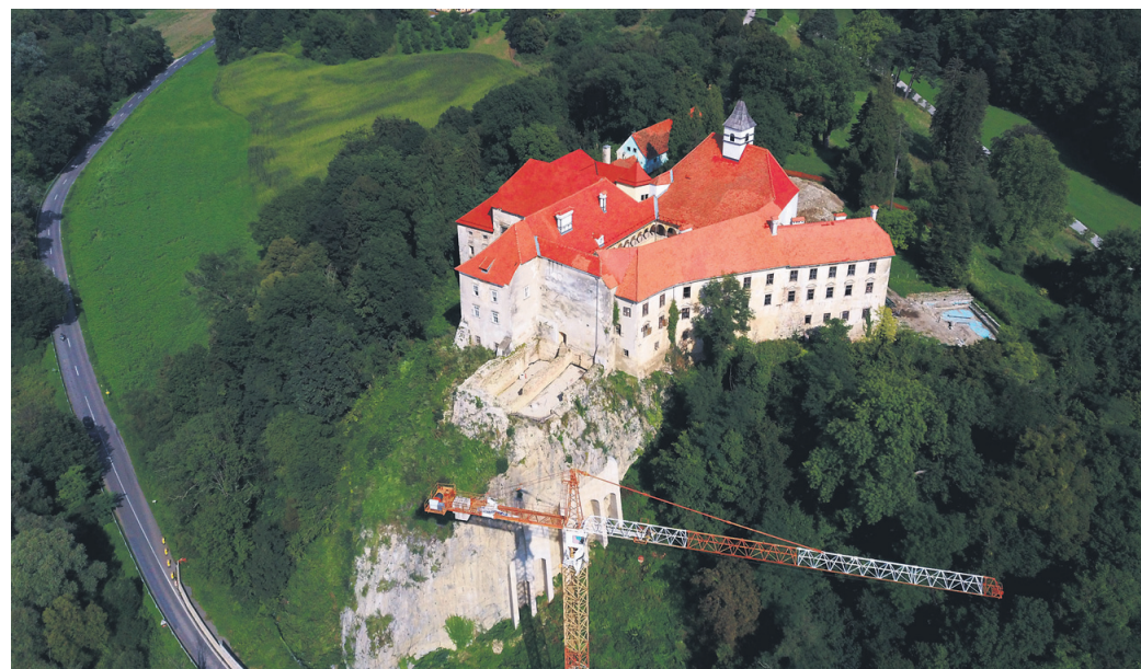
Direkcija za infrastrukturo naj bi še letos sanirala zidove grajske terase in namestila konstrukcijo razgledne terase. Prav tako bi moralo ministrstvo poskrbeti za obnovo zgornje terase, kjer so bila arheološka izkopavanja.
