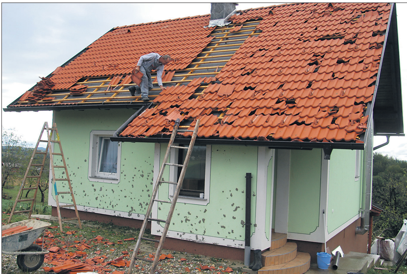
Pogled na hišo v Placarju 39 pri Ptuj, kjer je toča skoraj popolnoma uničila streho, precej pa tudi fasado in okolico.
