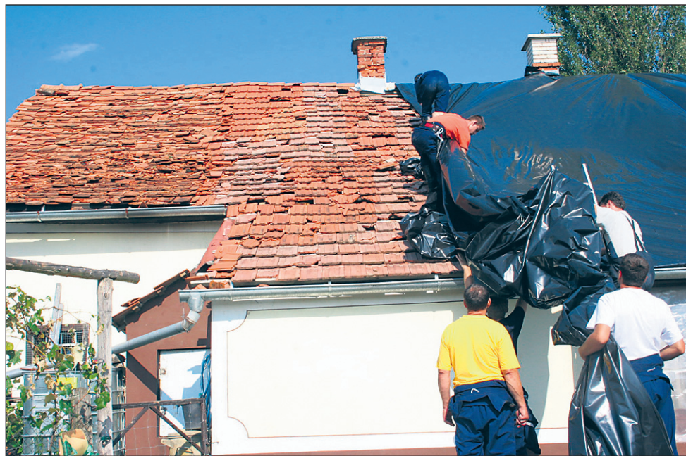
Gasilci so poškodovane strehe prekrivali s folijo.
