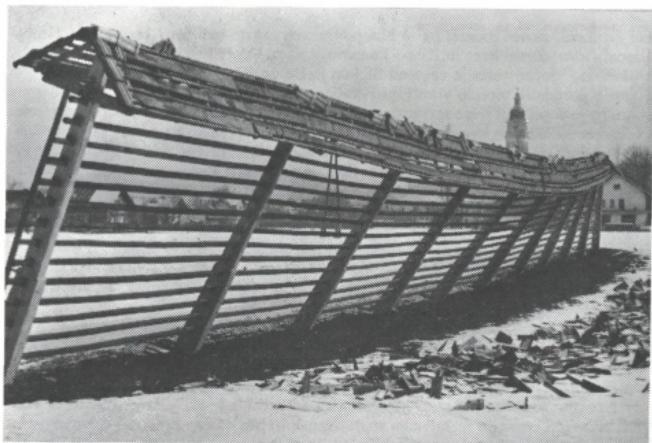
Sl. 14. Takole je veter nagnil in razkril 10 »štantov« velik betonski kozolec na Brezjah na Gorenjskem.
