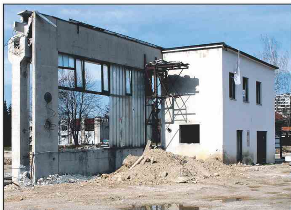
Tudi te ruševine nekdanjega Veplasa bodo kmalu preteklost. Za njimi že raste Lidl, ob njem pa bo zgrajen še nakupovalni center Super Nova.
