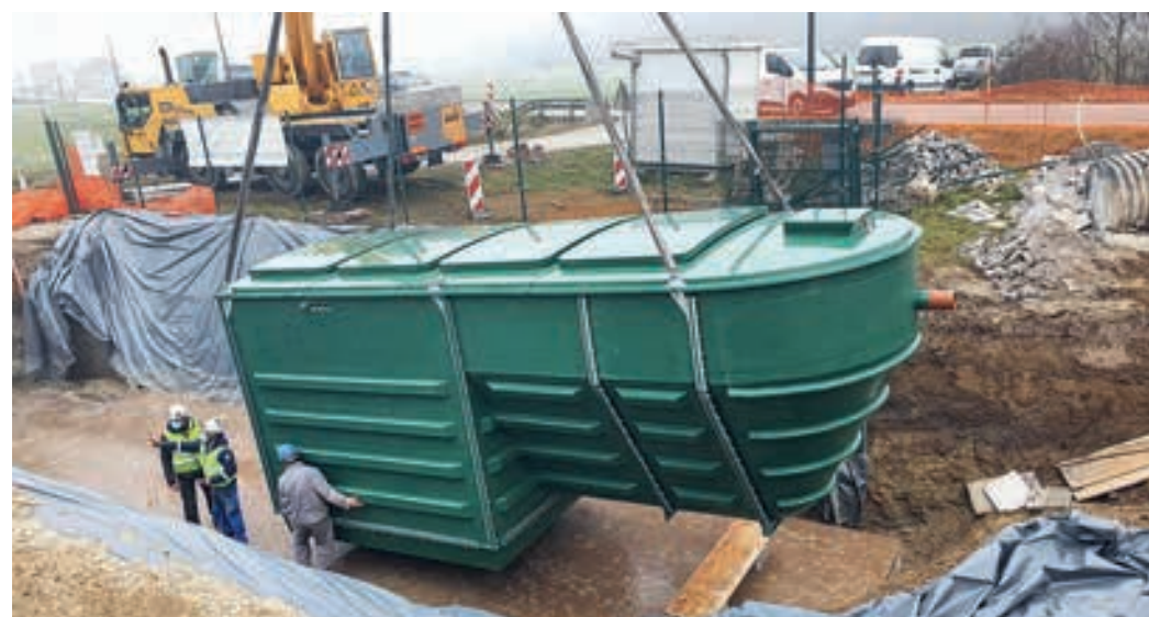
Tudi manjša čistilna naprava pomembno vpliva na vodotoke.
