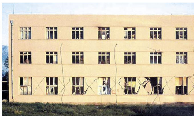
Slika 29 • Črna gora, 1979: etažni strižni mehanizem porušitve navadne opečne stavbe
