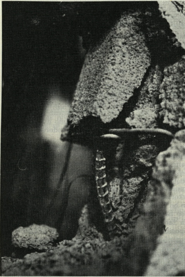
Slika 10. Uklon tlačne armature in drobljenje zidakov in zalivne mase pri upogibni porušitvi armiranega zidu
