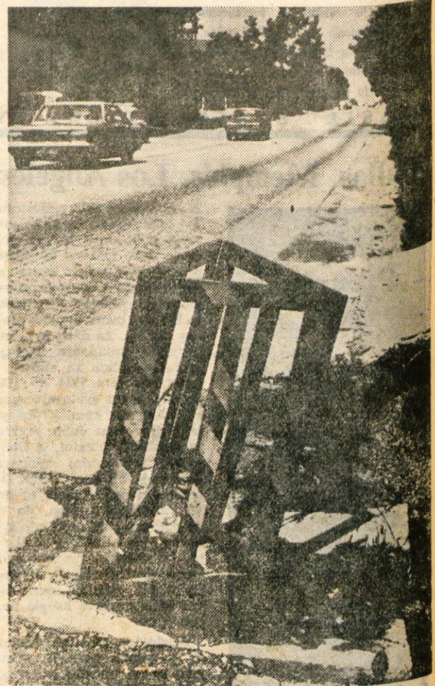
Ze dalj časa je, kar se je nasproti Vodovoda na Koroški cesti udrla betonska plošča. Na nevarnost nas opozarja samo ograja, ki je postavljena na vdrtno. Tamkajšnji prebivalci se sprašujejo kdo je odgovoren za to in kdaj bodo to popravili. — Foto: F. Perdan
