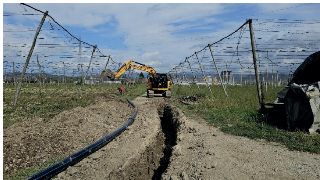
Menjave primarnih cevodovov v okviru II. faze posodobitev namakalnega sistema Novo Celje – polaganje PE cevi se izvede na peščeno posteljico s 15 cm obsipom. (Foto: I. Rihtar)
