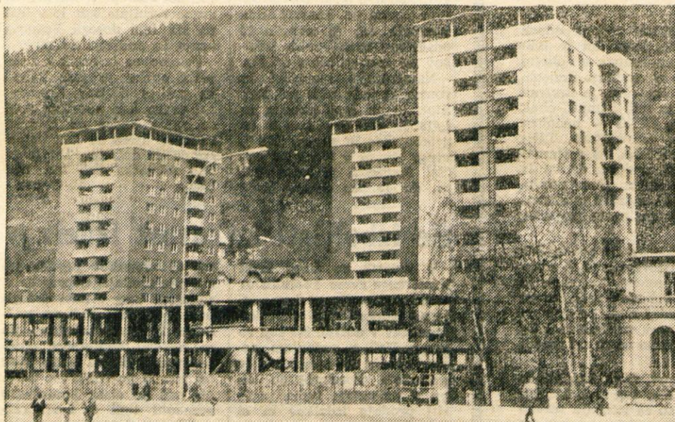
V bližini gimnazije na Jesenicah gradi gradbeno podjetje Gradis iz Ljubljane stanovanjsko stolpnico, v kateri bo 52 družinskih stanovanj, in trgovsko poslovno stavbo, v kateri bodo lokali, pisarne, mlečna restavracija in drugo. Dve stolpnici v tej stanovanjski soseski že stojita. Stolpnica, ki jo zdaj gradijo, in trgovsko poslovna stavba bosta predvidoma zgrajeni do 1. avgusta letos — Foto F. Perdan
