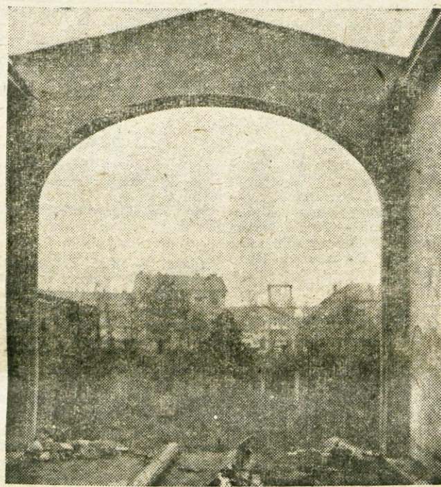
Včeraj so dokončno podrli viseči most čez Kokro v Kranju. Najprej so podrli streho in odstranili ostalo leseno konstrukcijo, včeraj pa so odstranili še nosilne jeklene vrvi.
