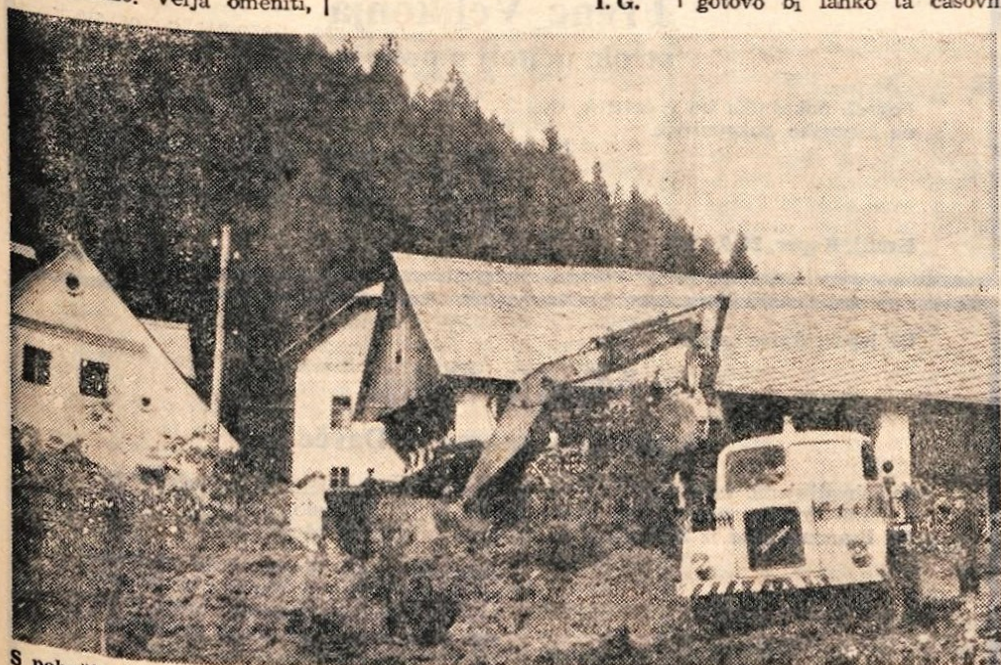
S pobočja pri vasi Podporezen v Selški dolini se je spričo neurja v nedeljo sprožil zemeljski plaz. Velike količine ilovnate zemlje so zatrpale cestišče in onemogočile promet. Na sliki vidimo delavce Cestnega podjetja Kranj, ki z bagrom odstranjujejo oviro.
