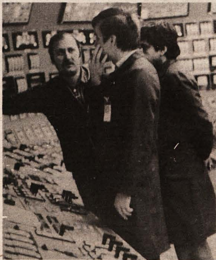
ZAHTEVNO PREVERJANJE - Posnetek je iz komandne sobe jedrske elektrarne v Krškem. V njej se prižiga na stotine kontrolnih lučk, medtem ko strokovnjaki ocenjujejo delovanje obratovalnih in varnostnih naprav. (Foto: Jožica Teppey)
