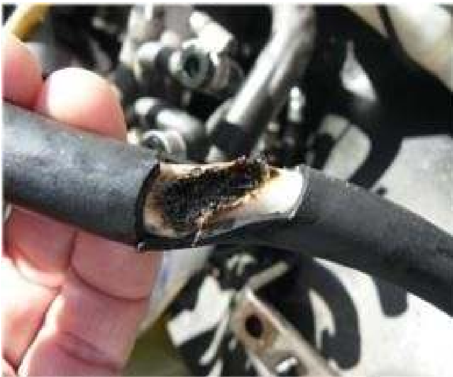
Slika 3: Zmanjšani presek vodnika zaradi poškodbe pri vrtanju
