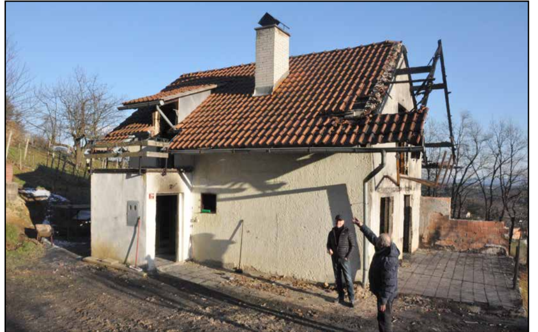
Po požaru so ostali le zidovi, zagorelo je v zunanjem nadstrešku.
