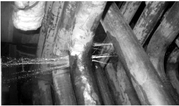
Figure 4: Leakage on superheater-P2 pipe bend Slika 4: Puščanje na P2 pregrevalniku na krivini cevi
