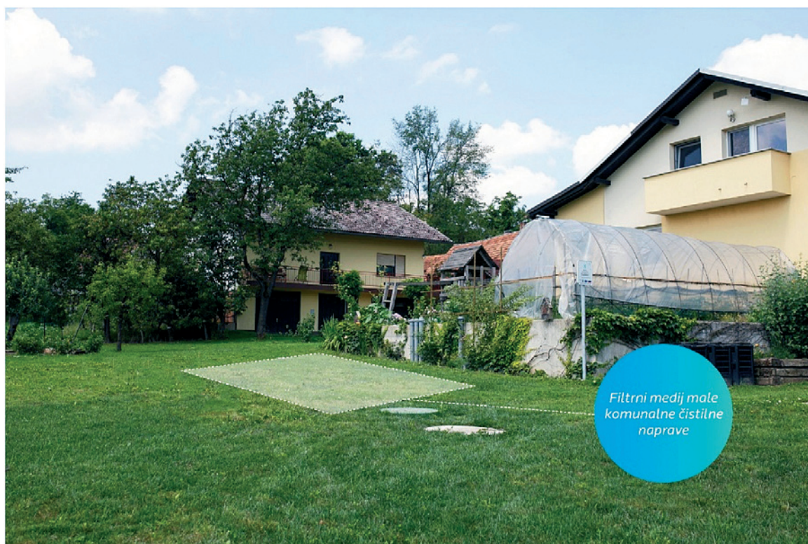
Slika 4: Pilotna mala komunalna čistilna naprava s filtrnim medijem.
