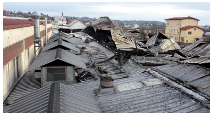
Streha proizvodne hale po požaru
