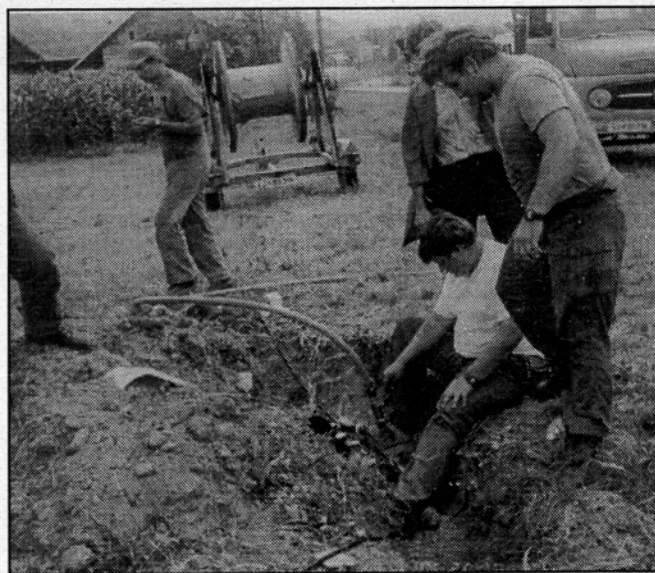
Kje so časi klasičnega polaganja telefonskega kabla? Optični kabel s pomočjo posebnega kompresorja enostavno vpihnejo, kot so to v Mozirju storili delavci podjetja Tegrad.
