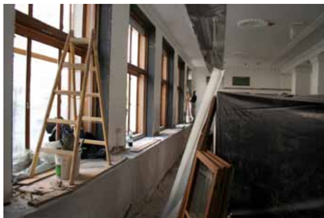
Slika 3. Vgradnja novih oken v glavni dvorani za stranke na Miklošičevi 24 z zunanje in notranje strani.
