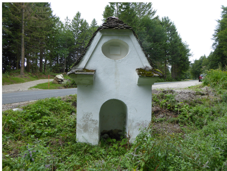
Slika 51: Današnja podoba kapelice ob cesti pod Ruško kočo in cerkvijo sv. Areha je le še bled spomin na nekdanj zgljedno oskrbovano občestno znamenje in čudežnim studencem pod njim, kjer voda ne teče več. Zaradi občutno dvignjene ravni nove ceste se kapelica dobesedno pogreza v močno zaraščeno zemljišče (foto: Vito Hazler, 2.9.2020)
