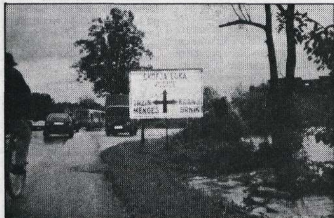
Nekaj deset metrov od križišča se je struga Pšate povsem približala regionalni cesti in jo že začela spodkopavati.
