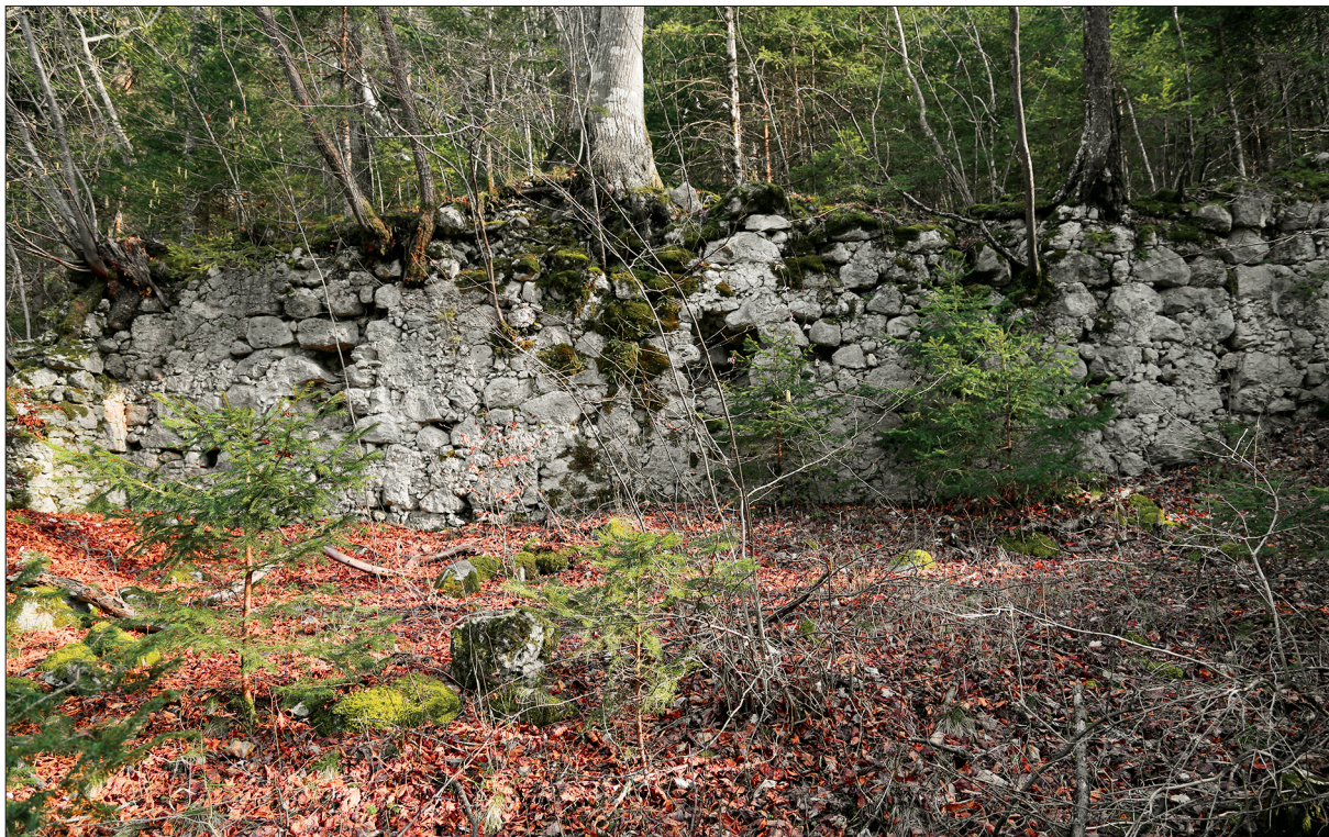
Pogled na razvaljeno notranjo steno nekdanje kašče gradu Glanz oziroma (Novi) Gutenberg. Na desni strani stene je vidna cezura, ki kaže obseg prvotne stavbe in mlajši prizidek (foto: Igor Sapač, 2020).
