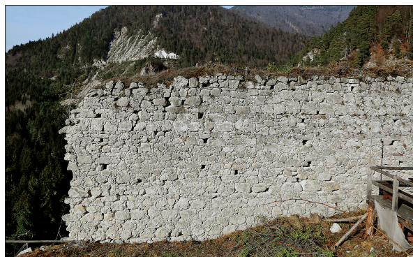
Struktura poznosrednjeveške kamnite zidave na dvoriščni strani zahodne stranice obodnega obzidja zgornjega dela gradu (foto: Igor Sapač, 2020).
